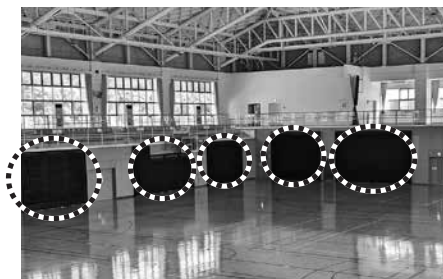
▲ 輻射式冷暖房を設置している体育館
