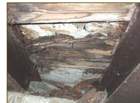
鋼橋主桁・床版の損傷
