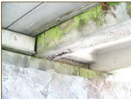
コンクリート桁の剥離・鉄筋露出
