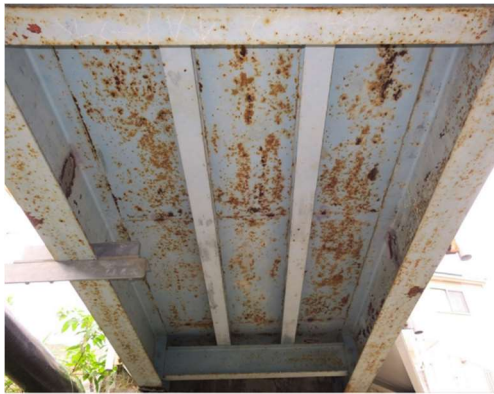
鋼床版の腐食・防食機能の劣化
