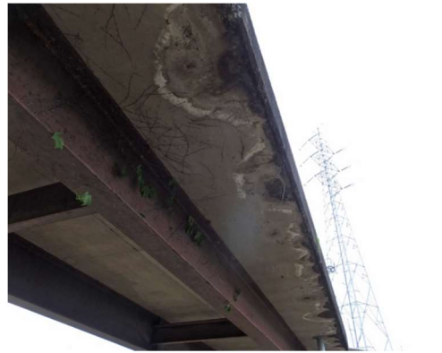
コンクリート床版の遊離石灰・鉄筋露出
