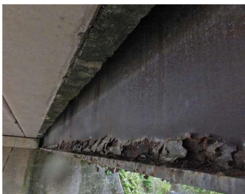
主桁の腐食・防食機能の劣化
