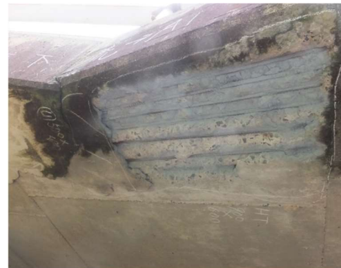
コンクリート床版の鉄筋露出・うき
