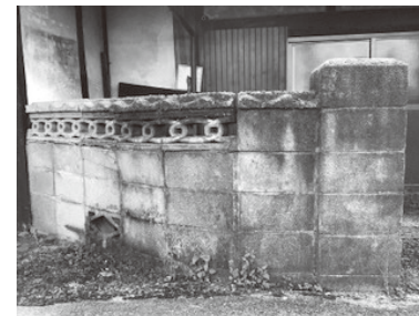
▲危険なブロック塀
