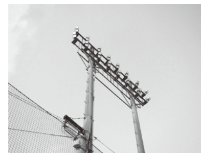
▲町民グラウンド照明
