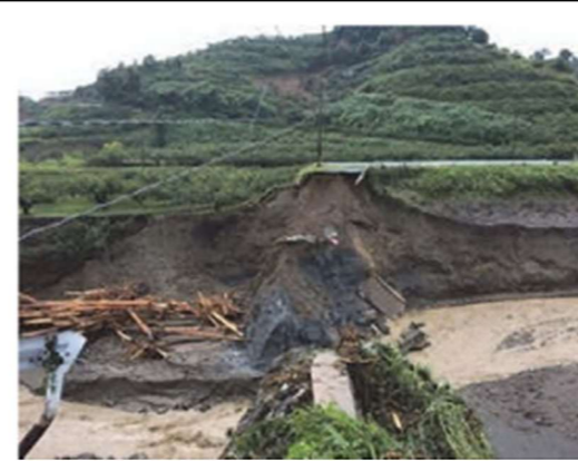
平成29年7月の豪雨により決壊(福岡県)
