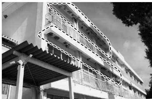
▲南校舎南面のコンクリートのはがれ
