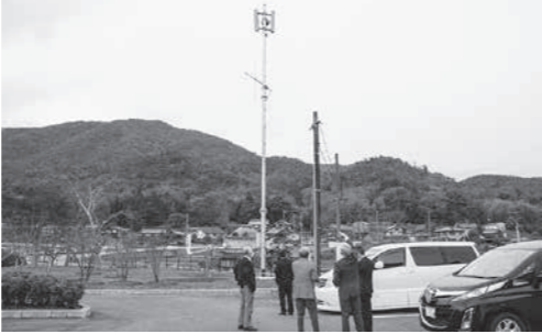
▲ 深原公園敷地内の中継子局
