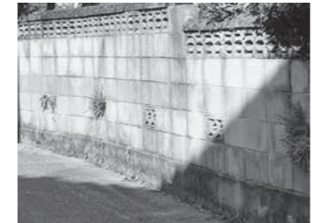
▲危険なブロック塀
