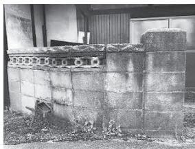
▲ 危険なブロック塀
