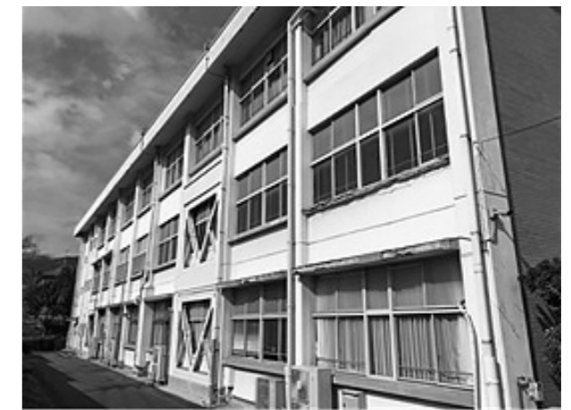
▲経年劣化が進む校舎（熊野第三小学校）
