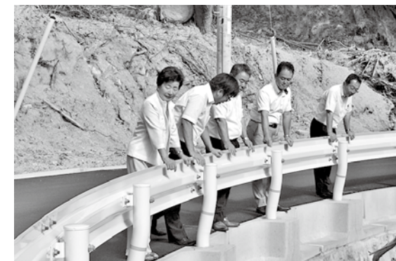
▲土砂災害により被害を受けた串掛林道の道路、ガードレール、水路の復旧状況を確認
