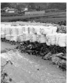
▲ 三谷川崩壊箇所
