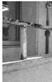
▲ 腐食した支柱
