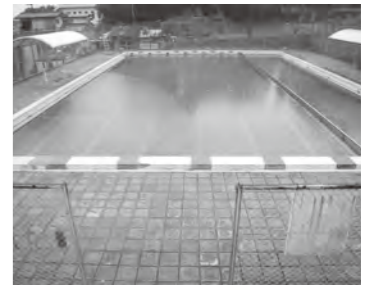
▲劣化が進む第二小プール
